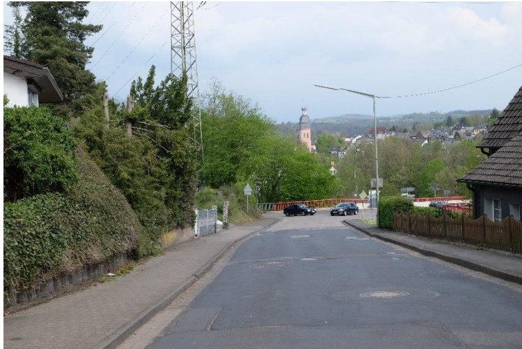
Am 24. Juli starten die Straßenbaumaßnahme Holschbacher Straße im ersten Bauabschnitt hinter dem Kreuzungsbereich zur Stadionstraße bis zum Abzweig Pirzenthaler Straße. (Foto: KB)
